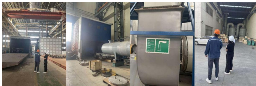
图 5-6 废气处理设施现场图
