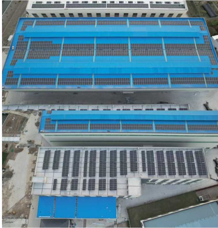
图 5-11 光伏现场照片
